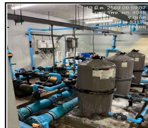
รูปที่ 7 : ห้องปั๊มสระ 7,8
