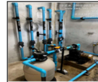
รูปที่ 9 : ห้องปั๊มสระ 9,10
